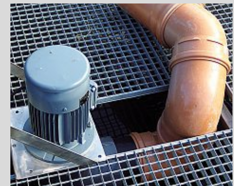
Pumpe Typ 05 in Betrieb montiert
